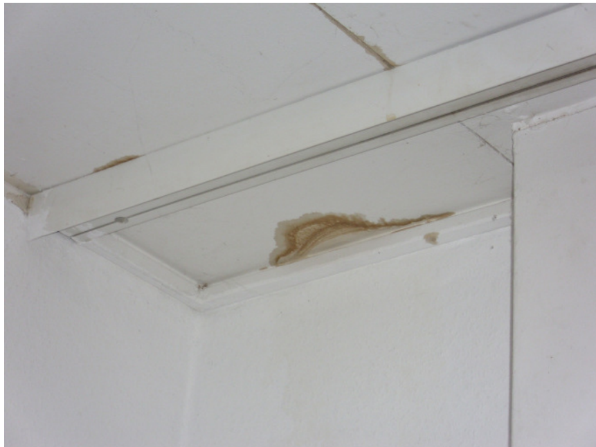
Ansicht Wasserschaden Decke
